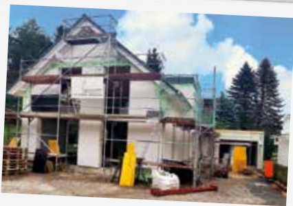
Nach einer Bauzeit von knapp zwei Monaten wurde Anfang September der Rohbau des Einfamilienhauses von Familie Schaffrath in Bergisch Gladbach fertiggestellt.
